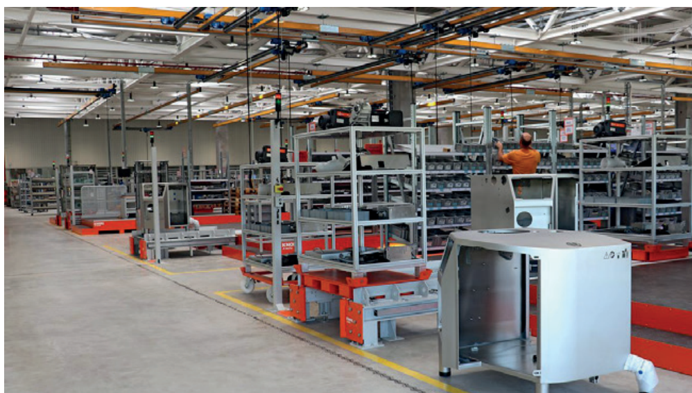
La nueva nave de producción de Handtmann está equipada con dos líneas individuales y una línea doble para el montaje de embutidoras al vacío; KNOLL desarrolló y suministró el sistema de transporte con rodillos de acumulación, junto con el CPA y la programación
