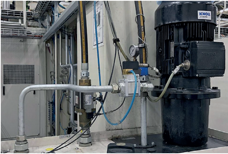
Knoll instaló una bomba de alta presión KTS en un centro de mecanizado: si hay que suministrar lubricante refrigerante a alta presión durante el mecanizado, las bombas de alta presión controladas por frecuencia ofrecen un gran potencial de ahorro
