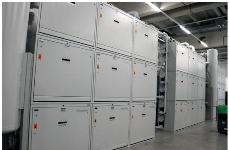
Gracias a su diseño modular, las instalaciones de limpieza centrales de lubricantes refrigerantes con filtros MicroPur® pueden realizarse en casi cualquier tamaño; esta instalación para soluciones acuosas ofrece una capacidad de limpieza de hasta 7.500 l/min de lubricante refrigerante
