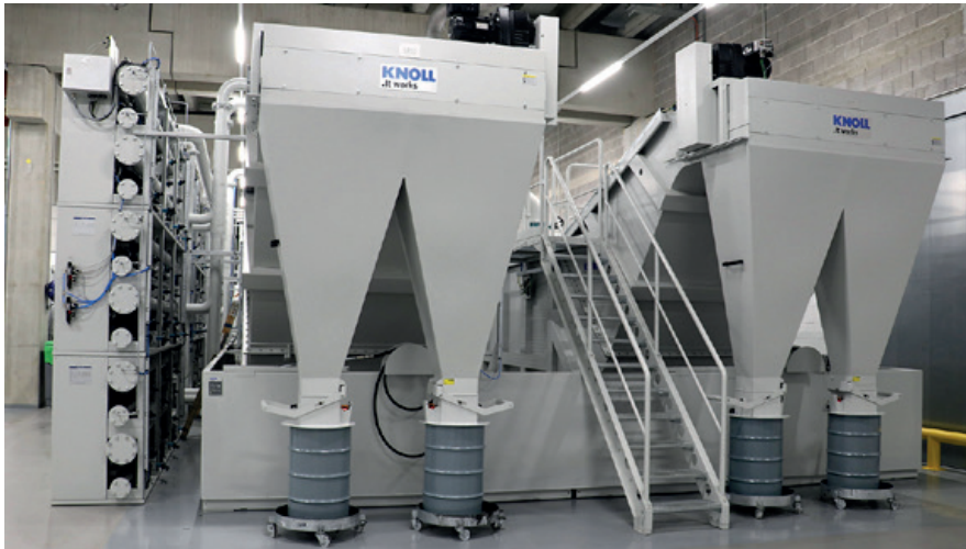
Instalación central de limpieza para solución acuosa: uno de los principales puntos fuertes del sistema MicroPur® es la superficie de instalación; en comparación con las instalaciones de filtración convencionales, solo se ocupa alrededor del 60% del espacio, con el mismo rendimiento
